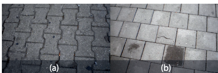
Obr. 1 příklad prvotního projevu degradace betonové dlažby (a) sprášení povrchu a (b) nerovnoměrné vysychání s porušením několika betonových kostek
